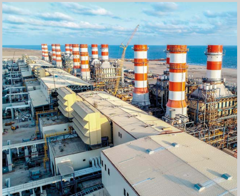
埃及Beni Suef联合循环发电厂 (CCPP)
